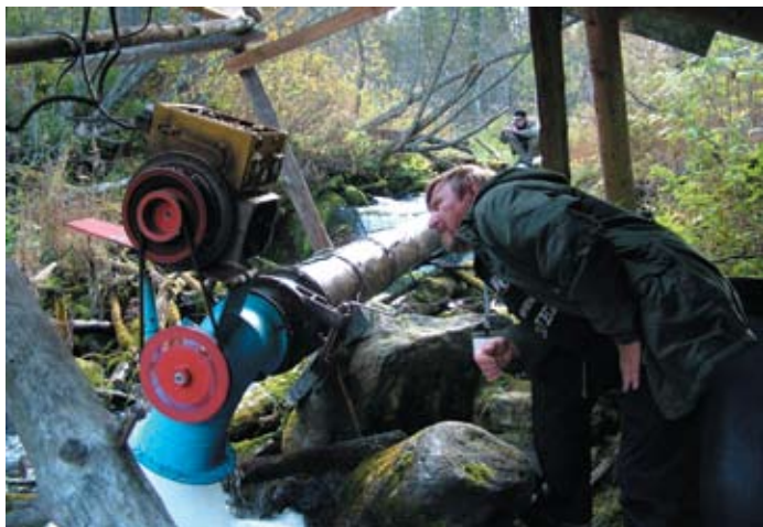
МиниГЭС 6 кВт на реке Малая Голая на юге Красноярского края.
