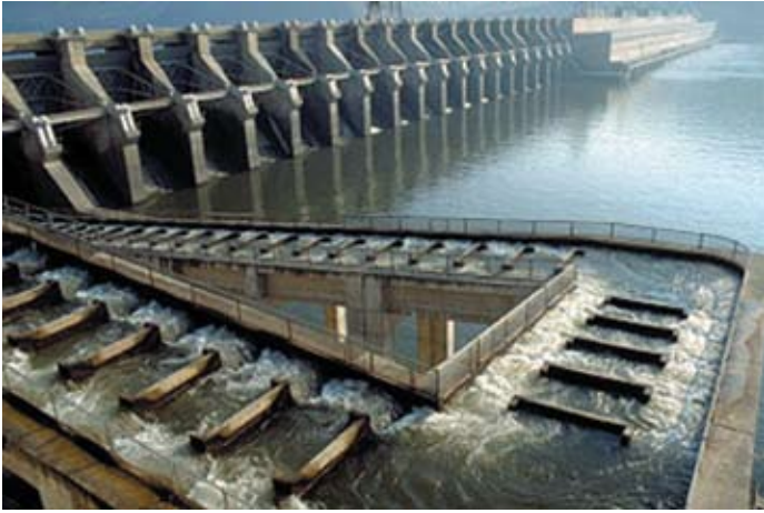
Рыбоход на ГЭС Джон Дэй (2160 МВт) на реке Колумбия, штат Вашингтон.
